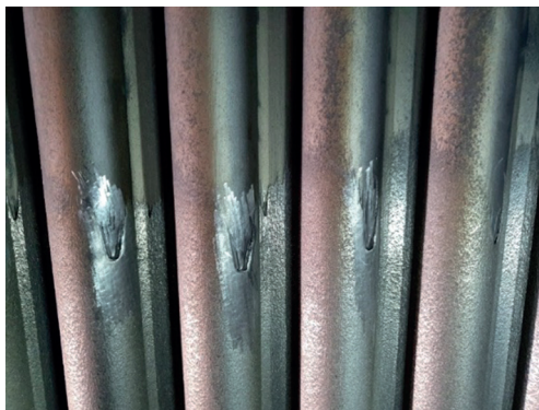
Rys. 1. Przykład uszkodzenia rur ścian ekranowych komory paleniskowej kotła fluidalnego typu CFB
